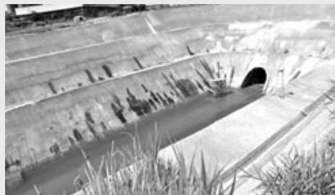
TRECHO da ferrovia em Anápolis, que precisa de reparos em túnel
